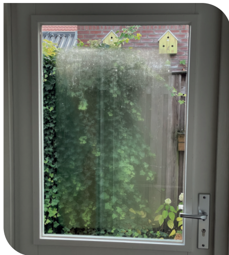
Condensvorming aan de kamerzijde.
